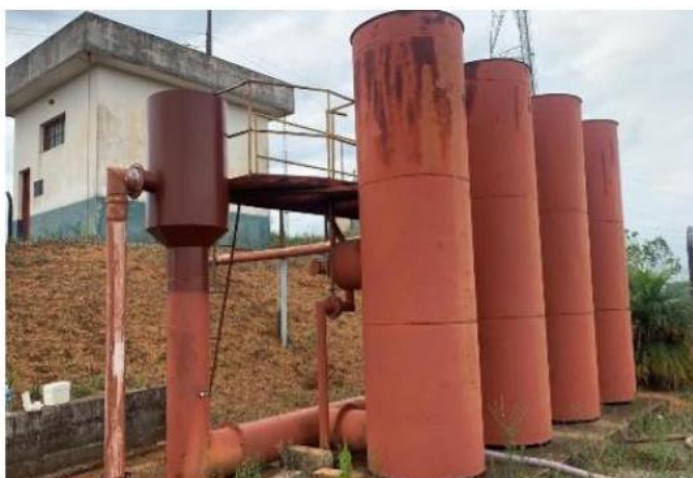
Foto 1 - Conjunto de Filtros
