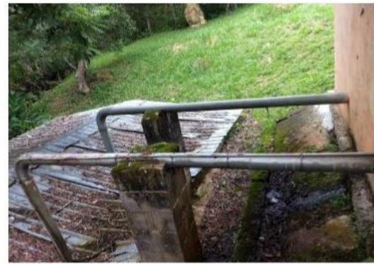
Foto 2 - Captação de água bruta
