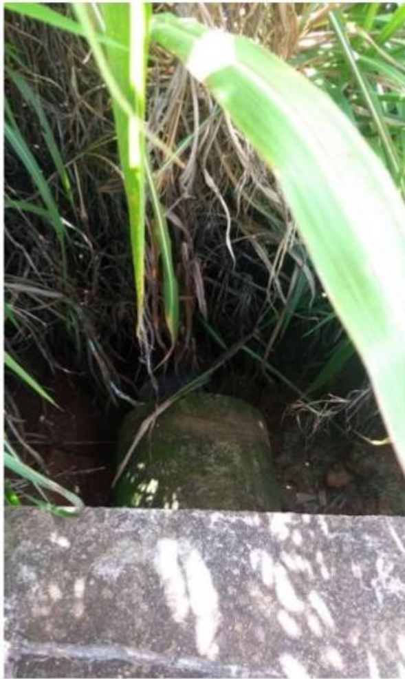
Foto 1 – Lançamento de efluente pela rede de águas pluviais
