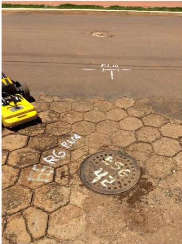
Foto 1 - Localização de rede e PV, marcação em piso.
