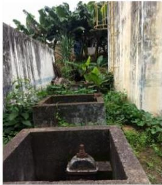
Foto 2 - Componentes da ETE desativada
