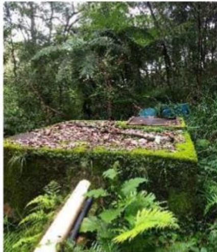
Foto 2 - Caixa de Passagem (CP)
