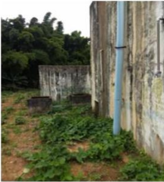
Foto 1 - Componentes da ETE desativada
