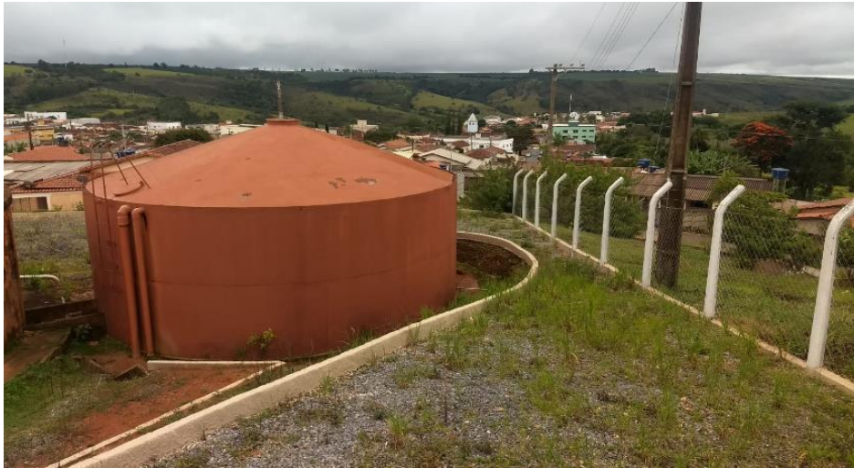
Figura 13 - Reservatório em aço da ETA
