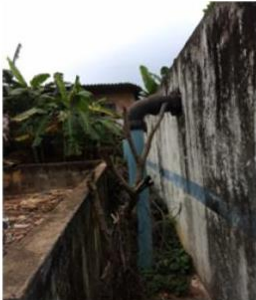
Foto 3 - Componentes da ETE desativada
